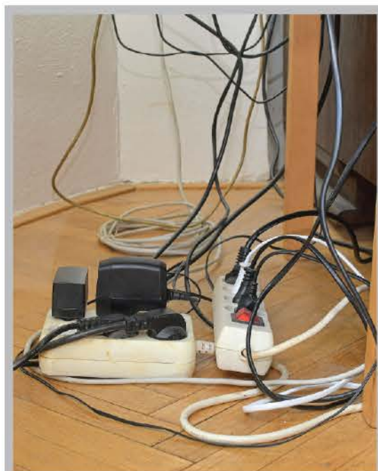
Kabel tidak rapi, Rumah terlihat berantakan
